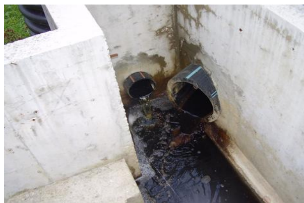
Slika 2. Okno sa ugrađenim mjeracem dotoka - ulaz drenažnih cijevi i miješanje procjednih voda (MS1) (Serdarević i saradnici, 2021)
