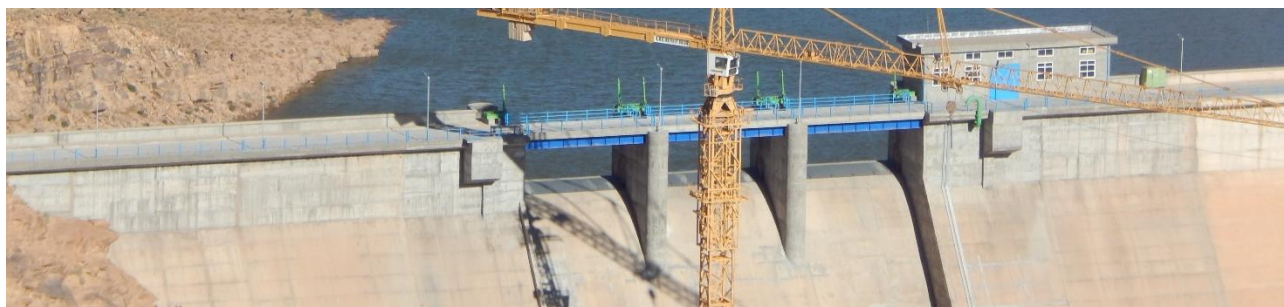
Slika 4. Pogled na prelivni deo brane Seklafa sa montiranim klapnama
