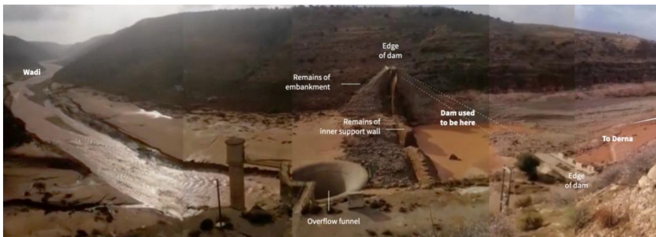
Slika 1. Pogled na uzvodnu srušenu branu Al-Bilad sa desne obale
