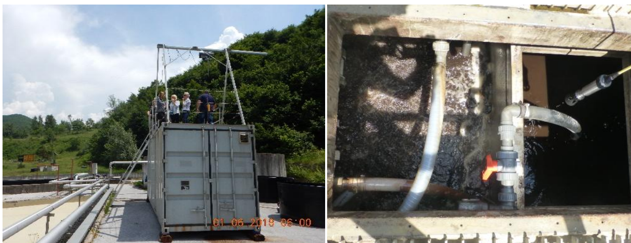
Slika 2. Kontejnersko pilot postrojenje na Smiljevićima lijevo i MBR pilot uređaj (nitrifikacija lijevo i anoksični dio desno) u pogonu juli 2018.godine [12]
