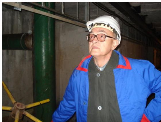
U injecciono-oskultacionoj galeriji brane Đerdap I
