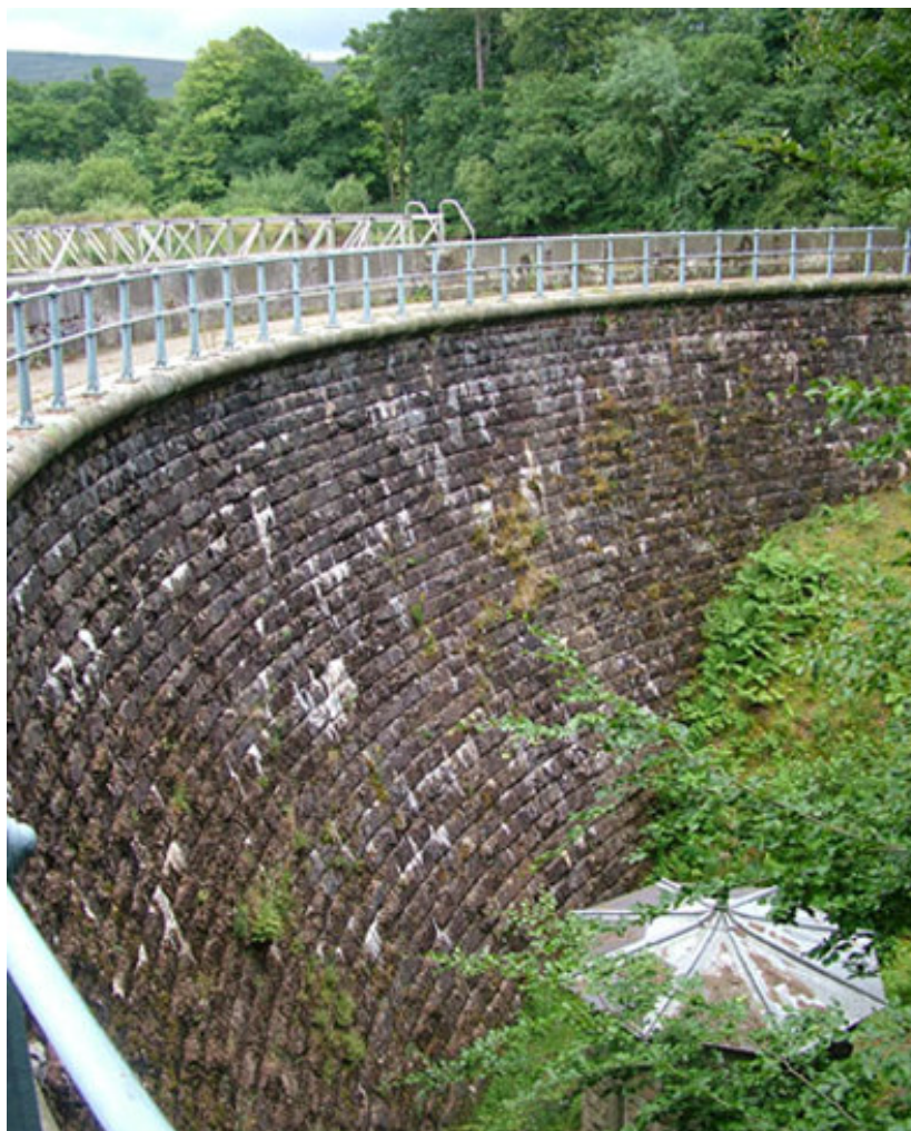
Слика 12. Поглед на зидану низводну страну гравитационе бетонске бране “Абејстед” саграђену 1881. године [13].
